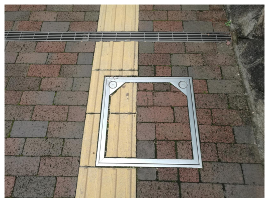
图 10-2 双层井盖不影响盲道
